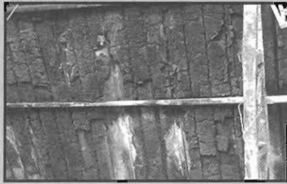
รูปภาพที่ 5 หลังคาเหล็กที่ปิดด้วยฉนวนกันความร้อน และดูดซับเสียงทำด้วยวัสดุติดไฟซึ่งสามารถลุกลามได้ง่าย
