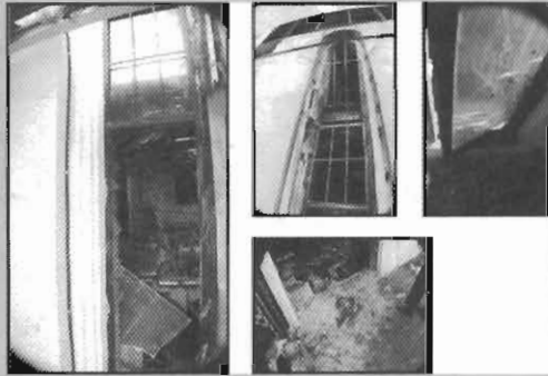
รูปภาพที่ 3 แสดงสภาพหน้าต่าง และกระจกหน้าต่าง ด้านข้างอาคาร
