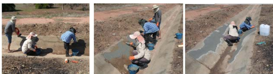
การซ่อมแซมรอยแตกร้าวมตามผนังคลองโดยใช้มอร์ต้าผสมน้ำยาง
